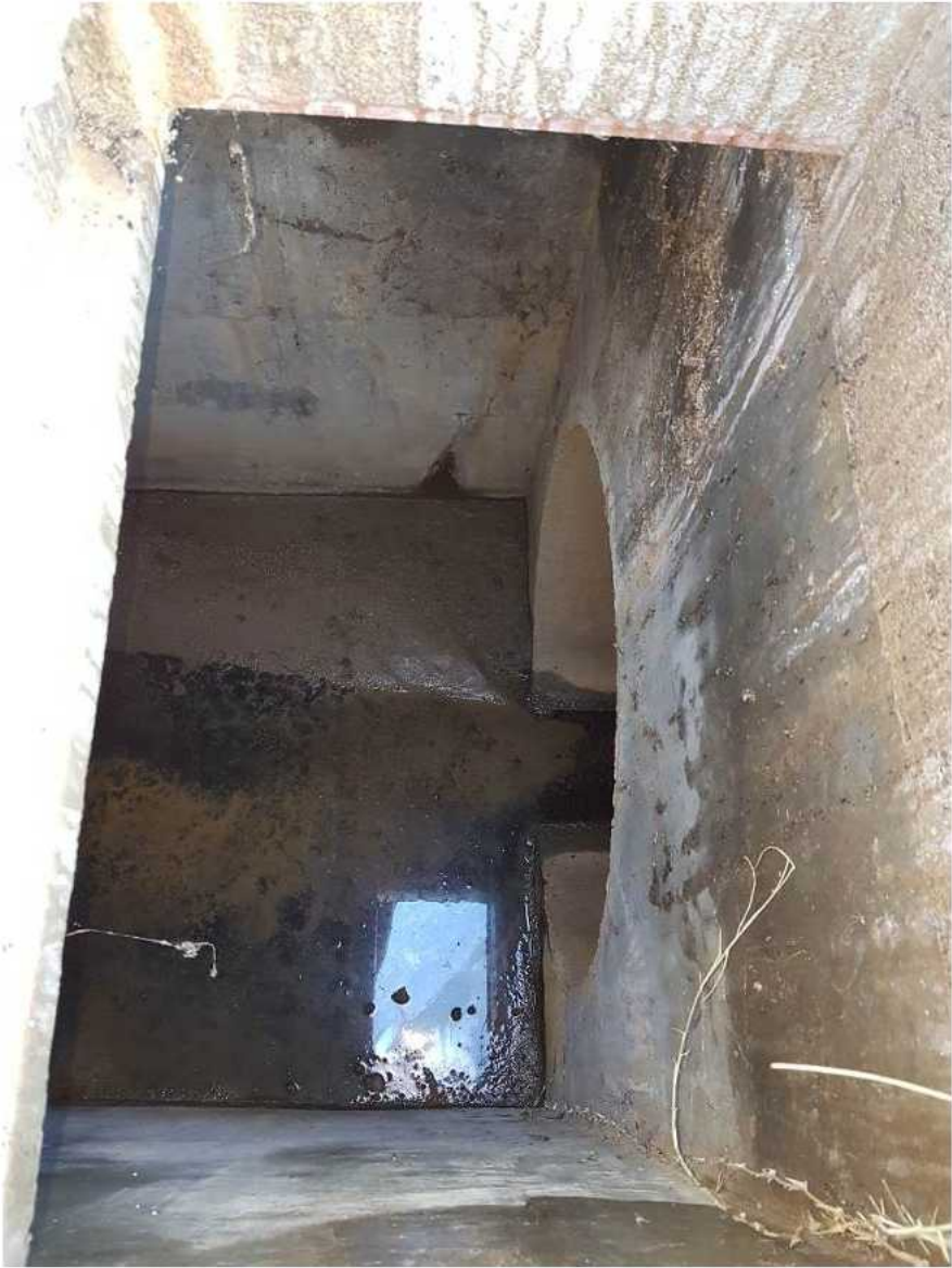
Detall de l'interior de l'arqueta que connecta amb el rec viver
