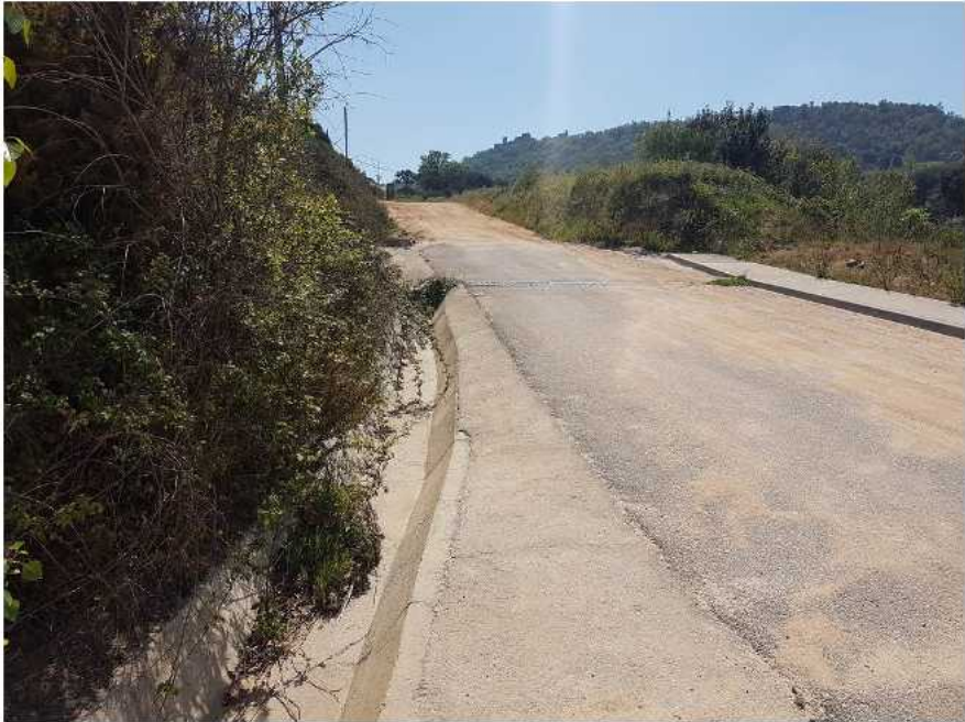
Recollida mitjançant cuneta de les aigües pluvials a la part superior del carrer
