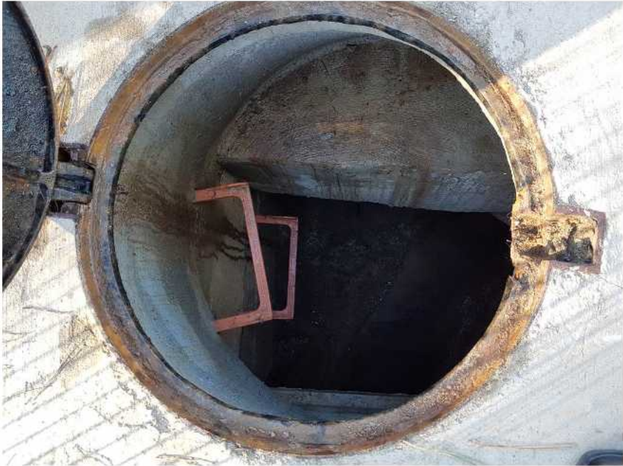
Detall de l'interior del pou que connecta amb l'arqueta del rec viver
