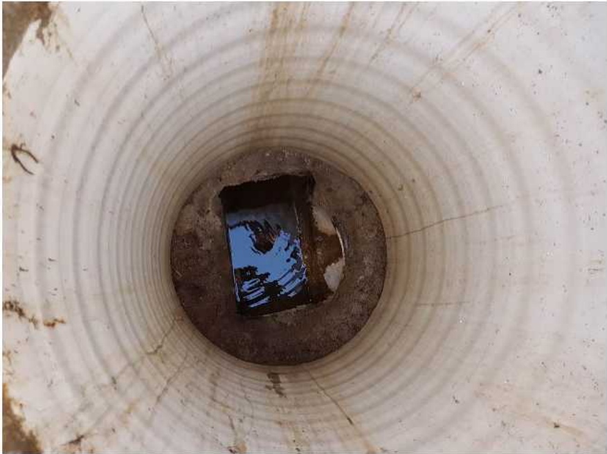
Detall de l'interior del pou de pluvials de la xarxa de clavegueram esquerda que connecta amb pou de l'arqueta del rec viver
